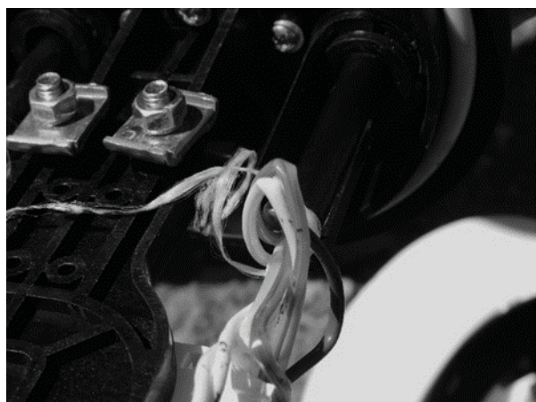
Рис. 1. Дефекты в муфтах, обусловленные «выдавливанием» оптических волокон из кабеля
